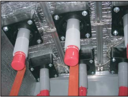
Intérieur du compartiment moyenne tension montrant le transformateur de courant suspendu (optionnel)
