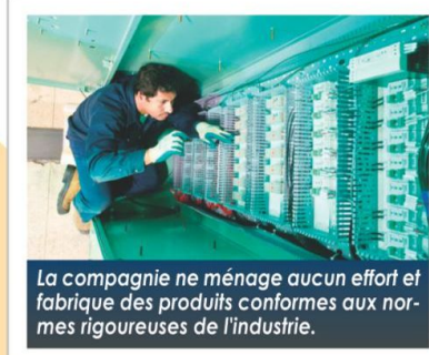
Nos équipes peuvent faire l'entretien de tous les systèmes de basse, moyenne et haute tension.
